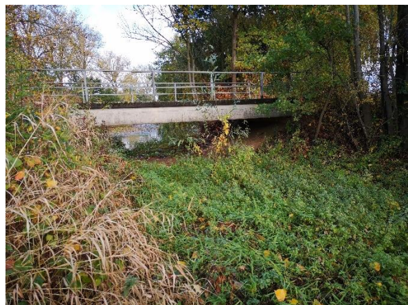
2 Verkräutung vor der Brücke
